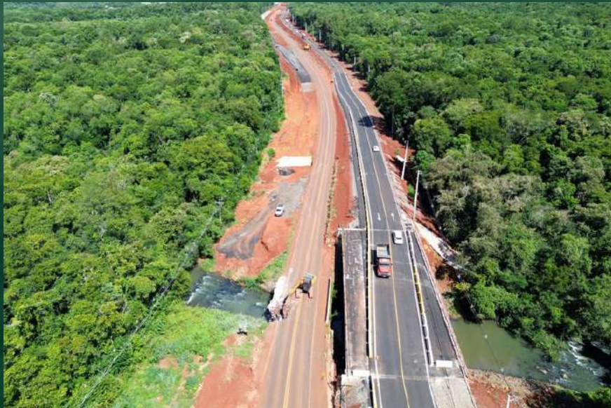
Figura 53 - Puente sobre el Río Tamandú (06/03/24).
