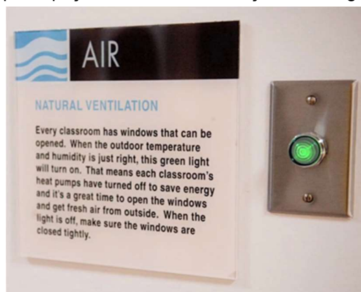
Figura 3.36. Sinalização permite aos usuários participação ativa na conservação de energia
